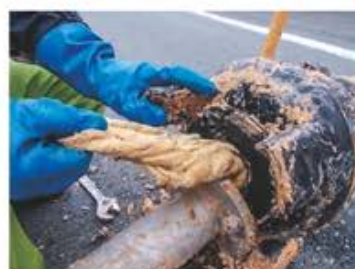
マンホールポンプに タオルが詰まっている様子
