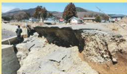
藤沼貯水池の決壊による被害
