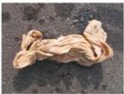
下水道のポンプに詰まっていたタオル
