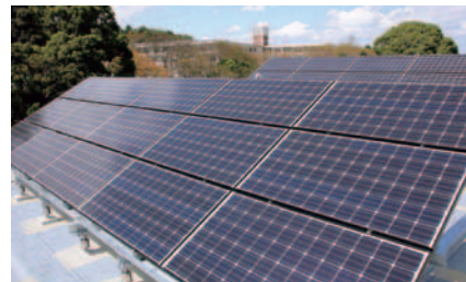
太陽光パネル
