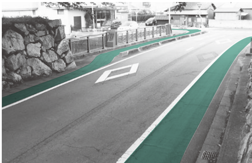
カラー路面標示（大手門橋）
