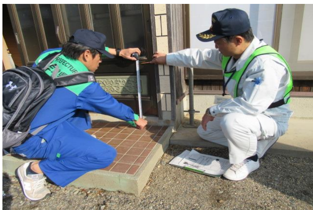
家屋被害調査（三重県、紀宝町ほか）
