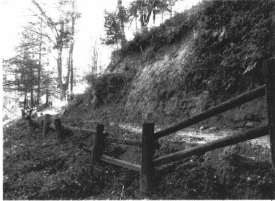
史跡・田丸城跡 のり面20ヵ所崩落
