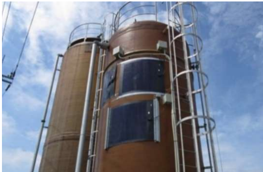
石油タンクに設置されたペロブスカイト 太陽電池を活用した太陽光発電
