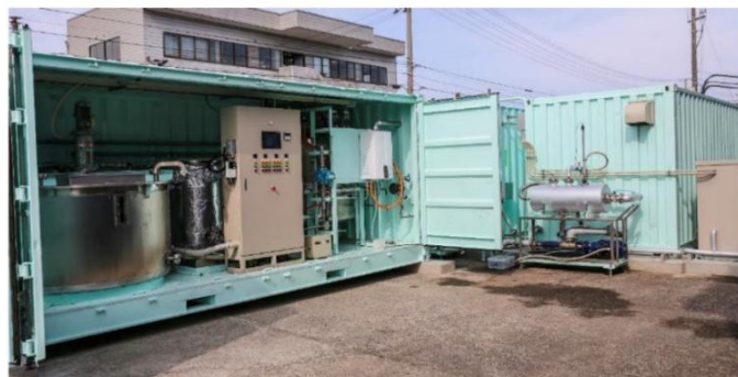
図 食品残渣等を活用した超小型バイオガスプラント
