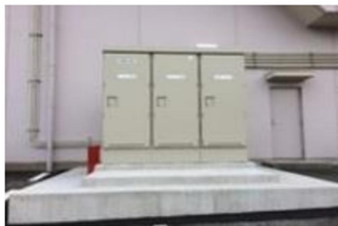
図 設置済蓄電池の様子(保健福祉会館)
