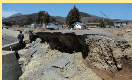
藤沼貯水池の決壊による被害
